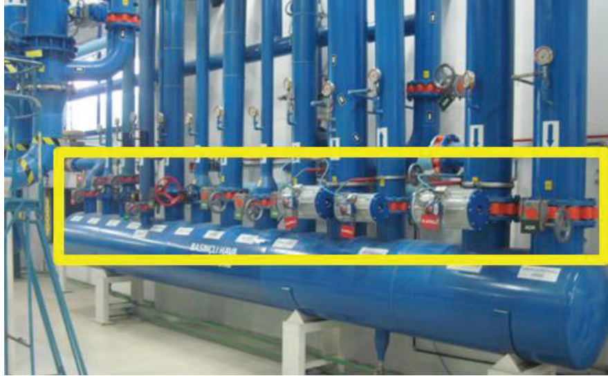
Şekil 10: Enerji merkezi kompresör dairesi basınçlı hava kolektörü bina hava hatları manuel kontrol edilen vanalar (ÖNCESİ DURUM)
