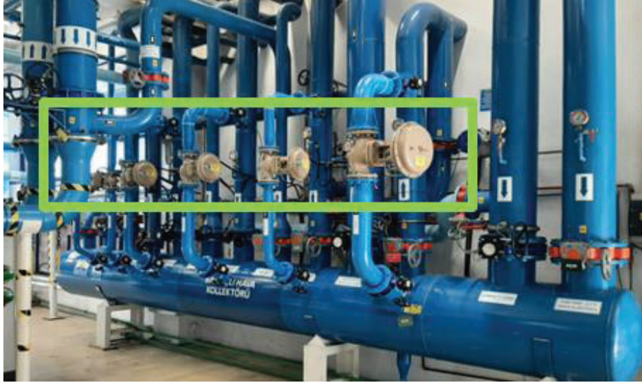
Şekil 11: Enerji merkezi kompresör dairesi basınçlı hava kolektörü üzerine montajı yapılan pnömotik kontrol (oransal) vanalar (SONRASI DURUM)
